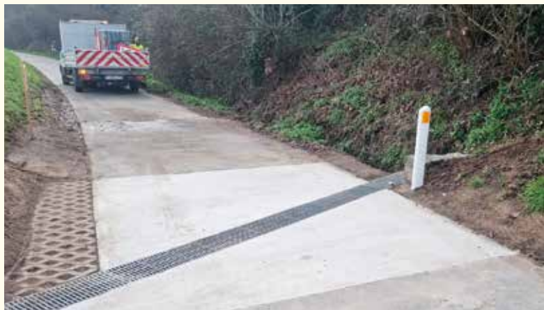
Afwateringsgeul over de rijweg om water te herleiden naar de gracht in de Pareelstraat.
